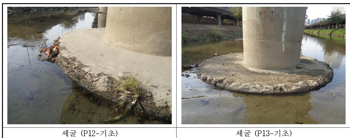
【그림 II-1.1.1】 신대방~구로디지털단지역 구간 기초 노출부 현황
