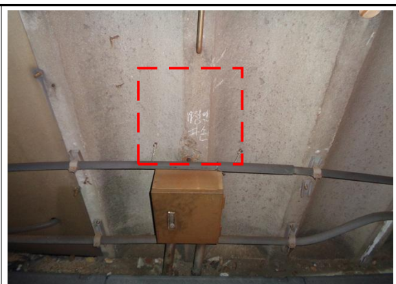
파손 (S15-내선 내측면)
