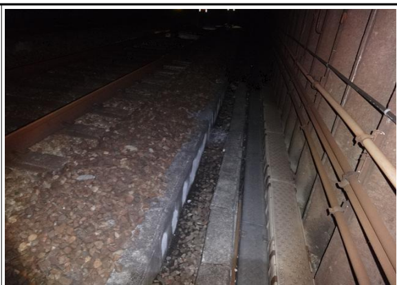
철근노출 보수 (S7-내선)
